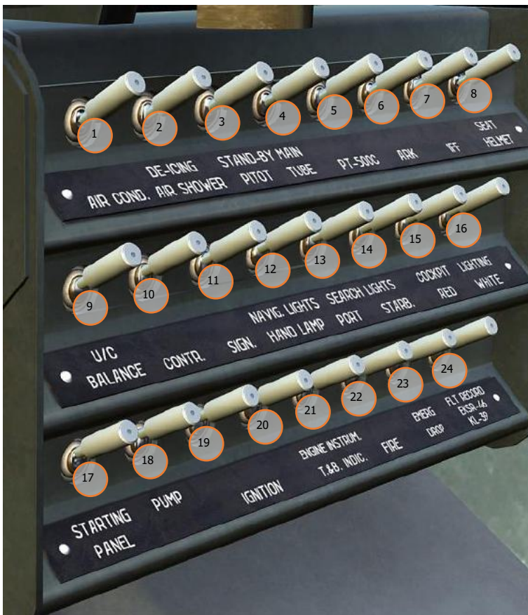
Figure 85 : Panneau auxiliaire des disjoncteurs de l'habitacle avant
