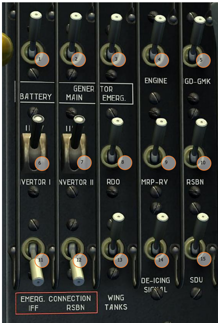
Figure 84 : Panneau principal des disjoncteurs de l'habitacle avant
